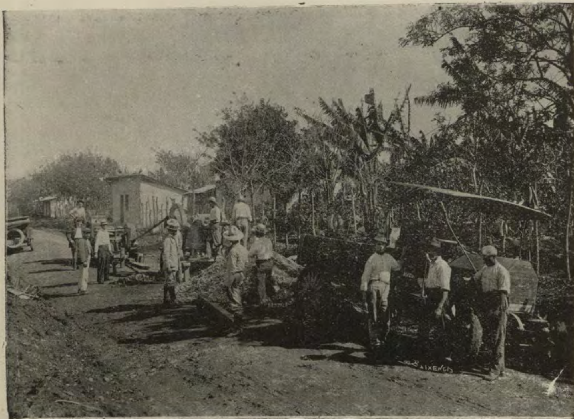
Carretera nacional de Alajuela y Heredia, trayecto de La Uruca a Virilla Quebrador de piedra preparando material
