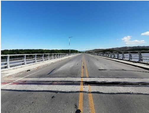
Figura N° 4. Junta en mal estado, puente La Amistad, Ruta Nacional N° 17
