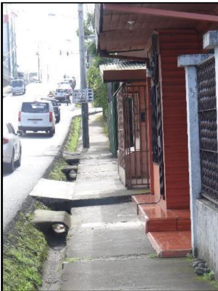
Imagen N° 45 Estado de las aceras, sector Curridabat.
