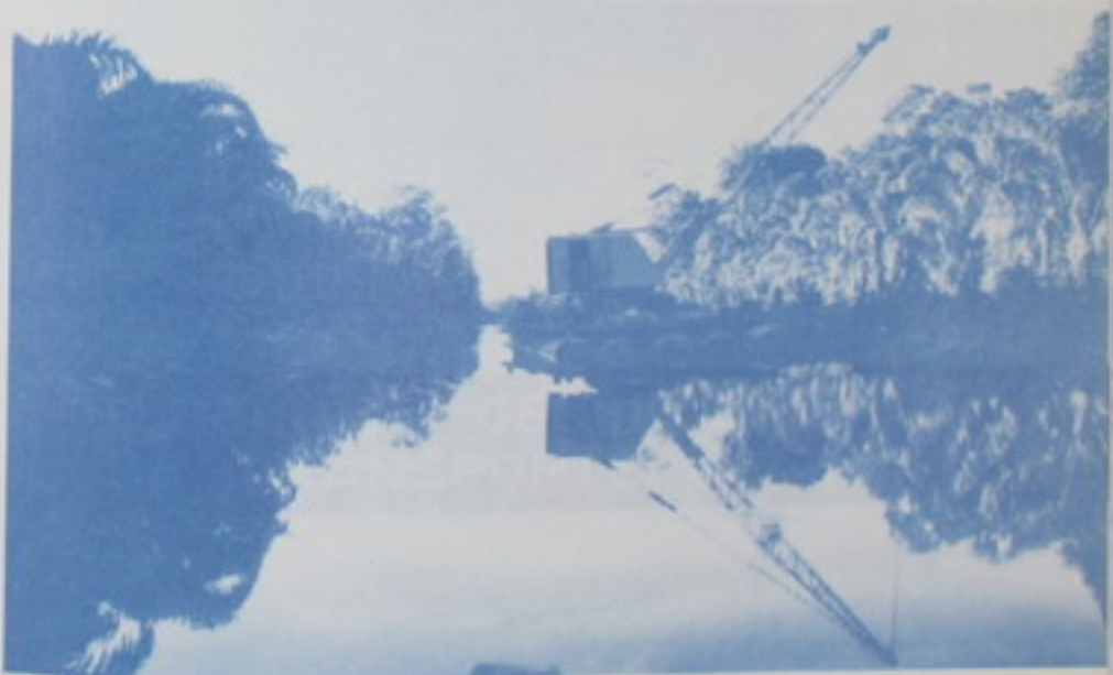
CANALIZACION: Se han completado 83,5 Km. de vías navegables en la canalización de las Lagunas del Atlántico.
