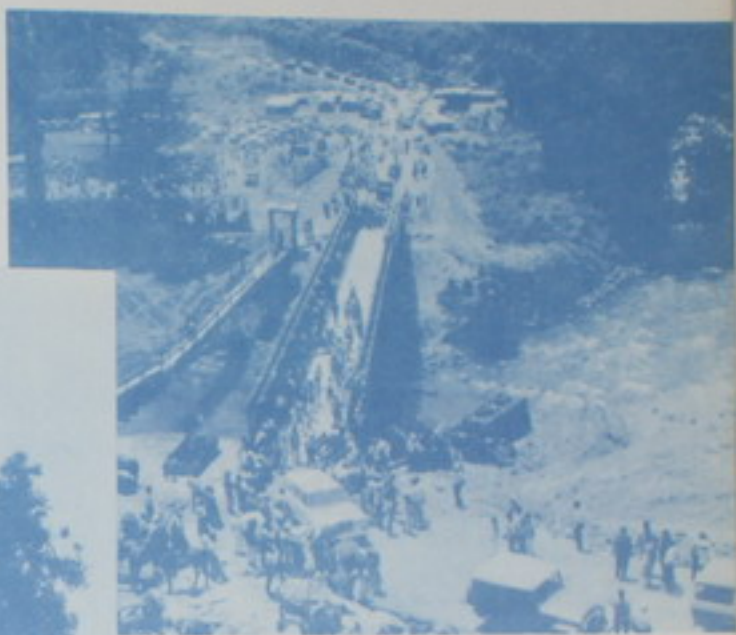
EMERGENCIAS: Puente Bailey de 55 m. de luz instalado por Defensa Civil sobre el cauce del río Arenal en San Carlos, como parte a la solución de la emergencia del Volcán Arenal.
