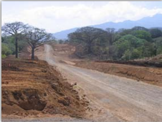
Vista del avance de las obras San José-Caldera áreas de atención al público con todos los servicios, locales comerciales y parqueos. A finales de abril pasado se cerró la recepción de ofertas para emprender el proceso de adjudicación de la obra.
