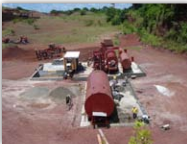
Planta asfáltica Cerro Chopo
