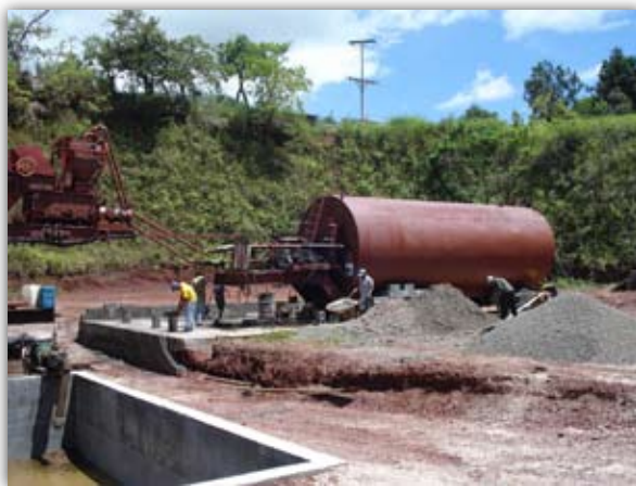
Planta asfáltica Cerro Chopo
