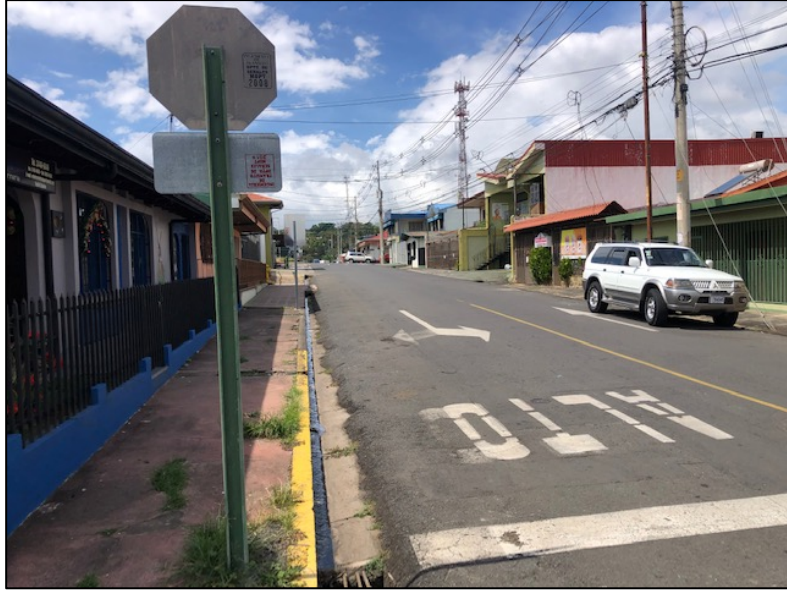
Figura 35. Señalamiento horizontal borroso, doble sentido de circulación
