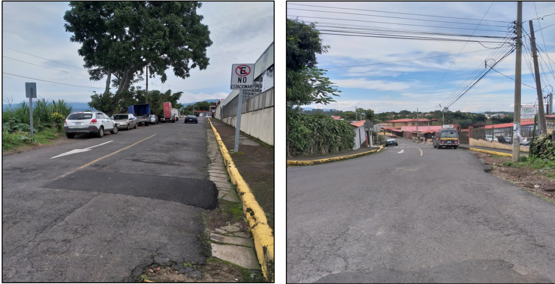
Figura 4. Señalización existente sobre calle 4 en ambos sentidos y presencia de baches en el asfalto.
