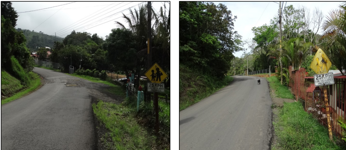
Figura N° 5 Señalización horizontal no existente, señalización vertical en mal estado en ambos sentidos.
