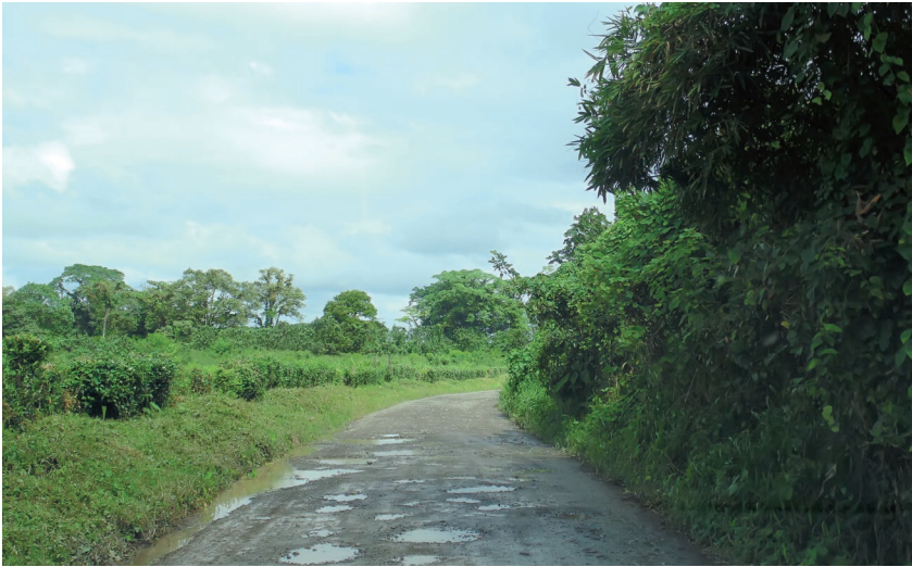
Camino con daños en la calzada en la Red Vial Cantonal.
