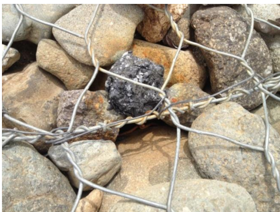
Figura 6. Daño por corrosión en la malla metálica de un muro de gaviones en la ruta 225. (Fuente: Autor)
