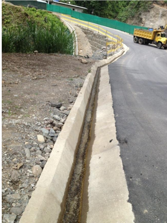
Figura 4. Cuneta recientemente construida por el ICE en buen estado y con capacidad hidráulica adecuada en la ruta 225 (Fuente: Autor)
