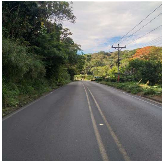
Figura 2. Señalamiento horizontal de doble línea amarilla borroso
