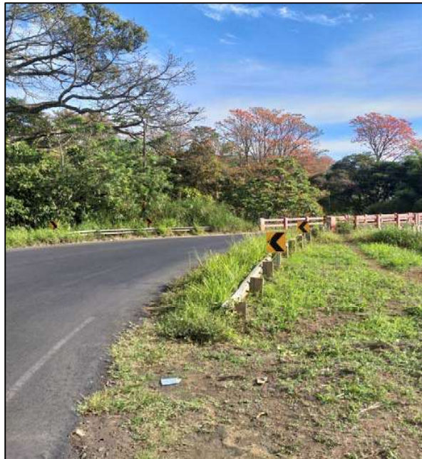
Figura 6. Espaldón en buen estado.
