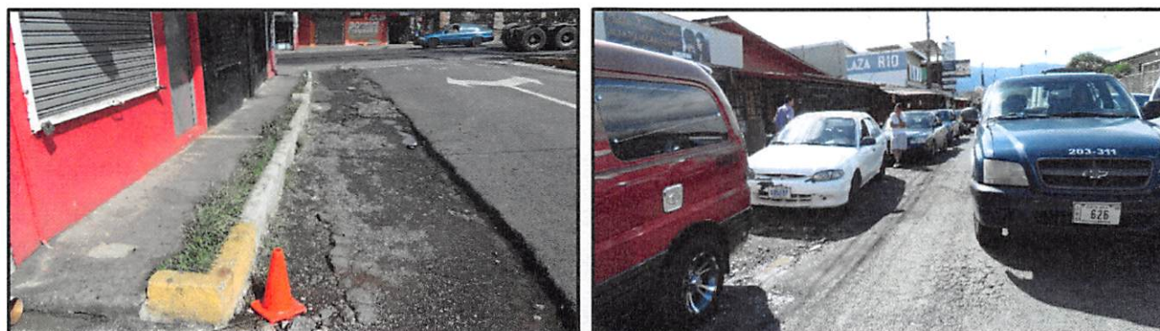
Imágenes N°8 y N°9. Vehículos estacionados en el sobre ancho. Fuente: elaboración propia, diciembre de 2018.
