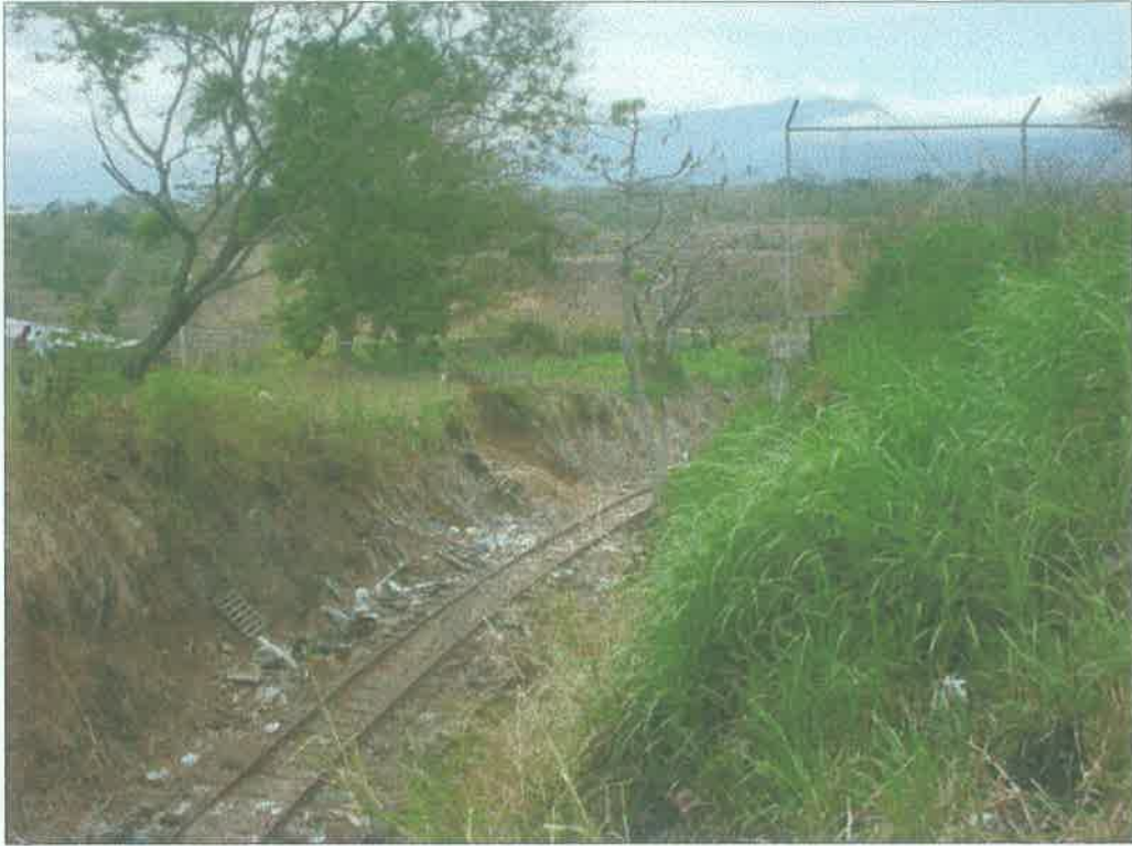
Cruce del ferrocarril sobre el Río Virilla.Desvío.
