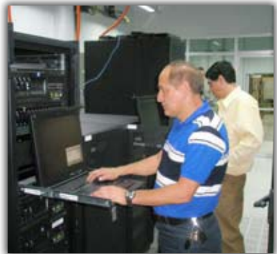
La seguridad física y ambiental del "data center" fue mejorada sustancialmente durante el periodo
