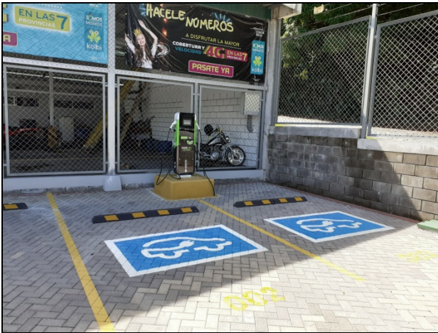
Imagen 4. Espacio para carga de vehículos eléctricos.
