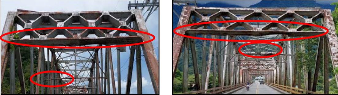
Figuras 8 y 9. Daños en las cerchas superiores puente del Río Térraba.
