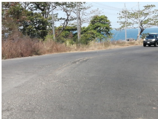
Figura 13. Carretera asfáltica en mal estado, sector mirador de Jacó
