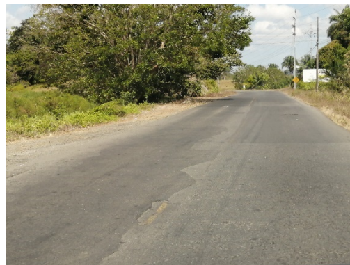
Figura 14. Pavimento en mal estado, después de Las Vueltas de Parrita camino a Quepos
