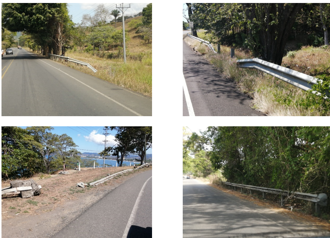
Figura 29. Barreras de contención en mal estado
