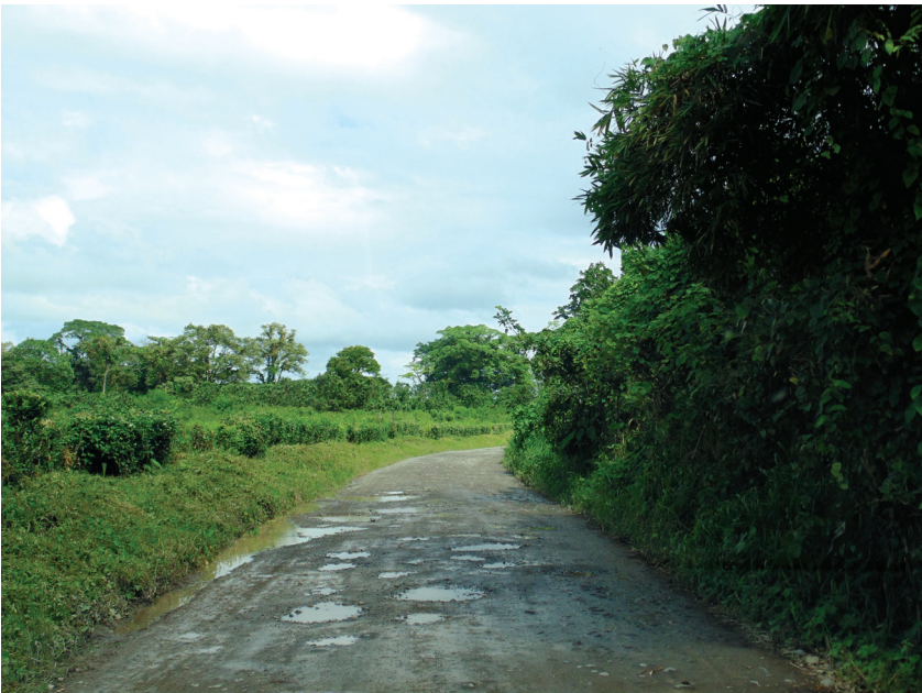
Superficie de rueda con estancamiento de agua en la Red Vial Cantonal
