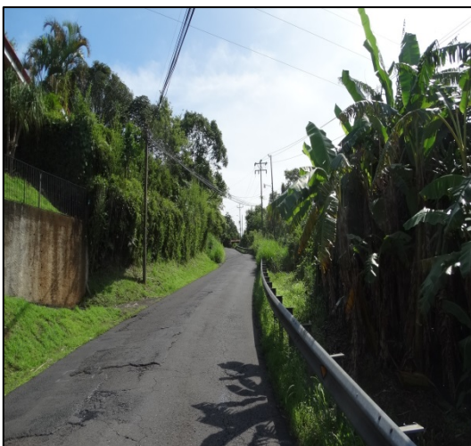
Figura N° 2. Tramos sin aceras, zonas verdes y calzada en mal estado.
