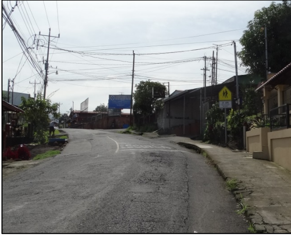
Figura N° 3 Señalamiento horizontal borroso, vertical en regular estado
