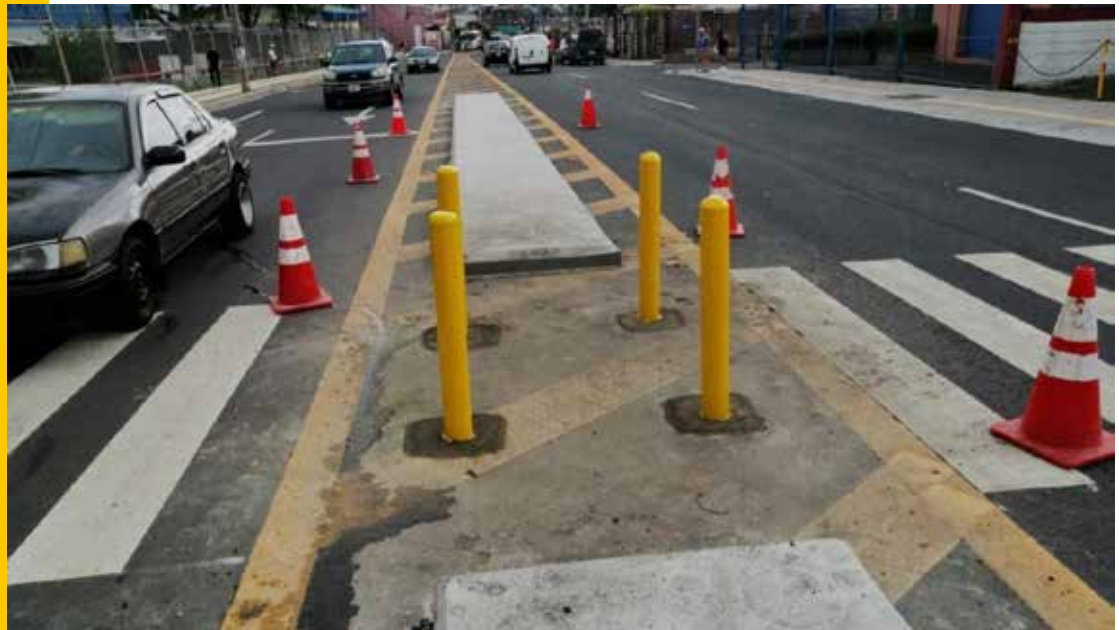
Imagen 79. Paso de cebra como parte de la obras del carril exclusivo de la troncal San José -Pavas. Fuente: CONAVI, 2020.
