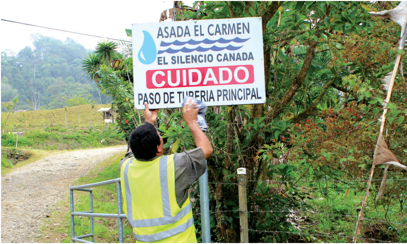
Labores de limpieza de señales verticales. COOPEPUEBLOS UNIDOS R.L El Carmen cantón de Turrialba
