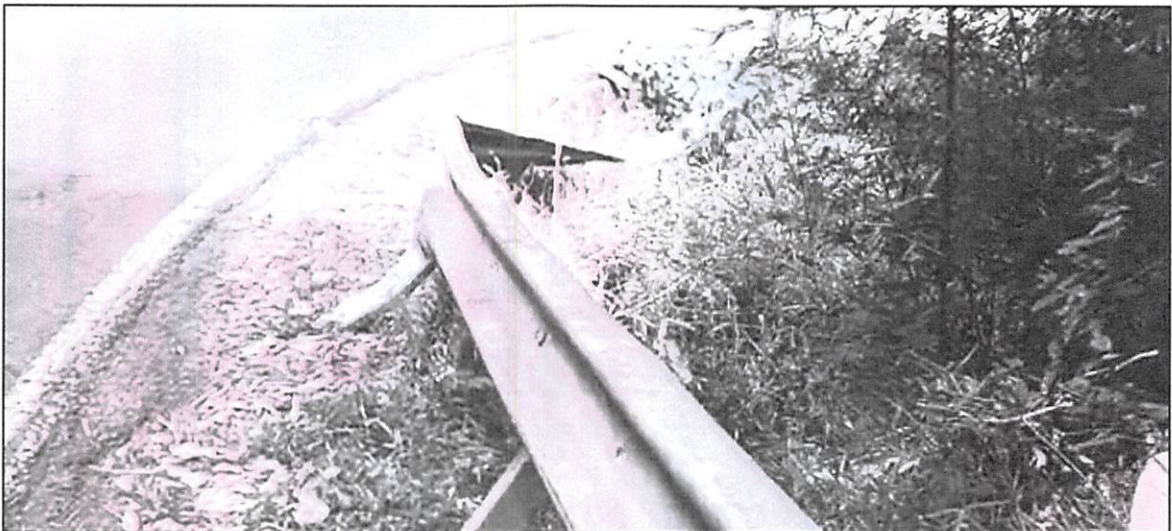
Figura 5 Daños en la estructura de la barrera de contención vehicular, ruta nacional N.º 209, Aserrí, San José. Fuente: Téc. Osvaldo Piedra.
