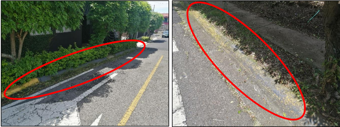
Figuras 3 y 4. Secciones con pintura gris frente al comercio AQUAFIT y cordón amarillo muy desgastado, vía cantonal 409086-00, Urb. Lomas de San Pablo, Heredia. Fuente: Propia.
