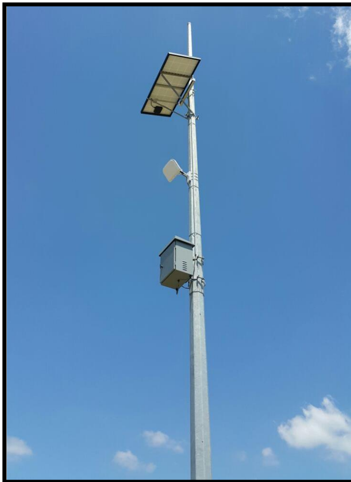
Figura 1: Estación permanente de radar, compuesta por un panel solar, el dispositivo detector de radar y el gabinete de control
