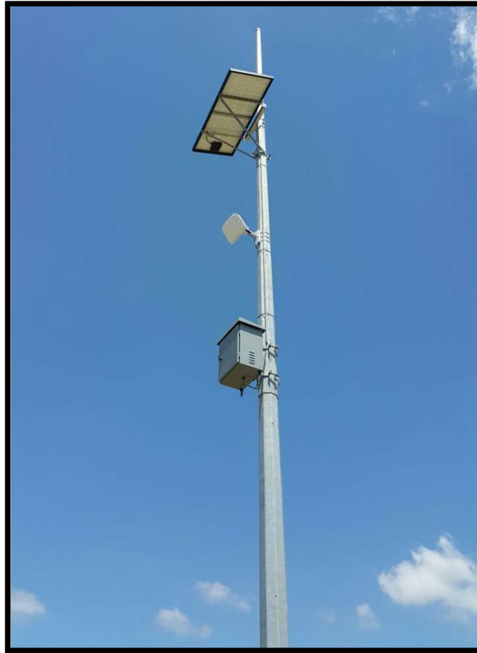
Figura 1: Estación permanente de radar, compuesta por un panel solar, el dispositivo detector de radar (color blanco) y el gabinete de control
