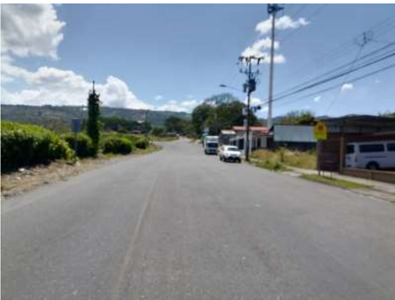
Figura 2. Superficie de rodamiento acceso este de la interacción
