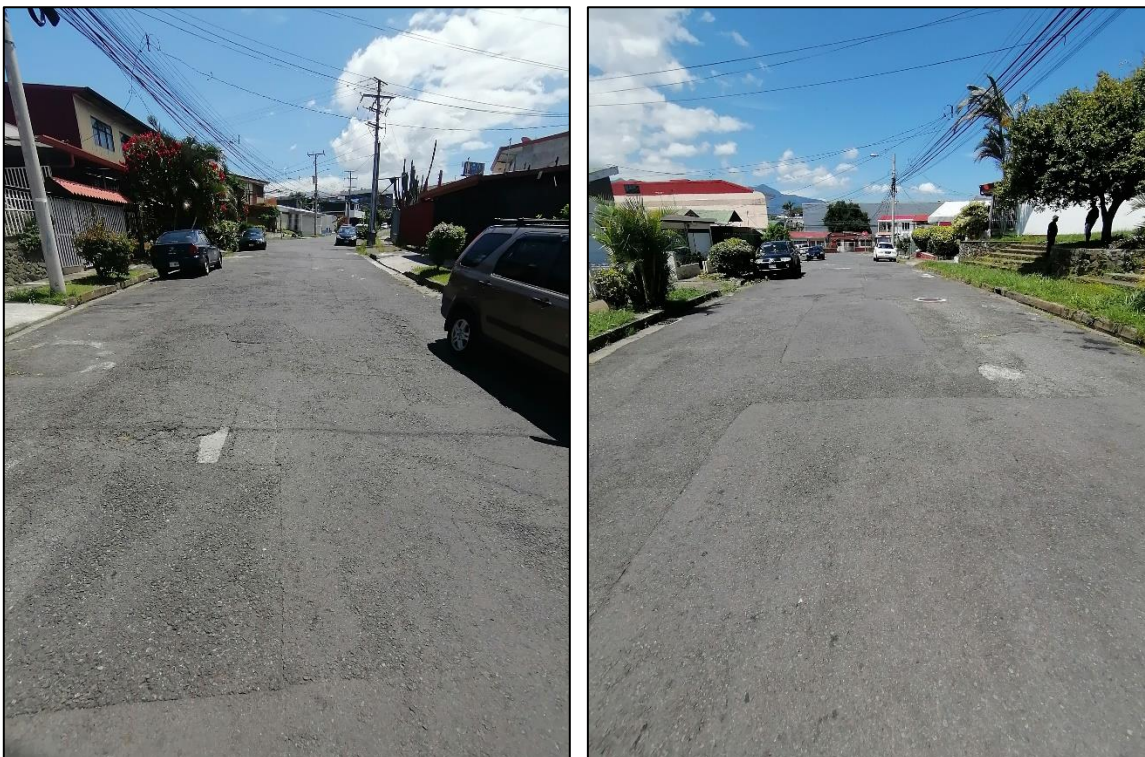
Figuras 3 y 4. Vehículos estacionados distanciados ambos lados de la vía y baches y grietas en carpeta de rodamiento, Avenida 22 entre Calles 41 y 43, Zapote, San José. Fuente: Propia.
