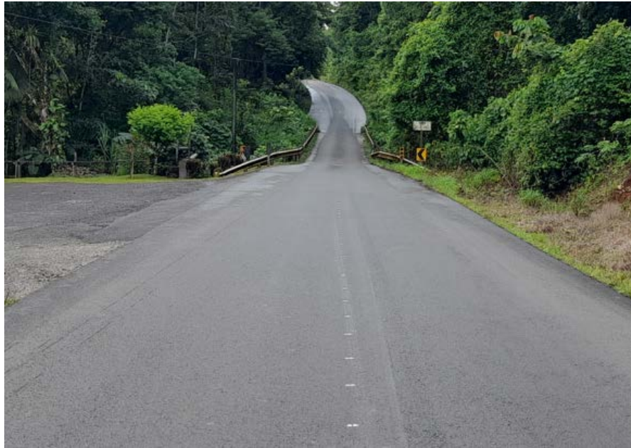
Figura 14. Puente sobre el Rio Las Delicias antes de la señalización
