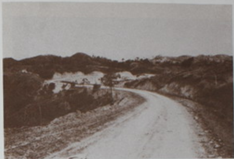
7. - Proyecto Puriscal - Parrita. Long. : 62 kms. Se construye dentro del Plan Cooperativo con la Municipalidad de Puriscal.
