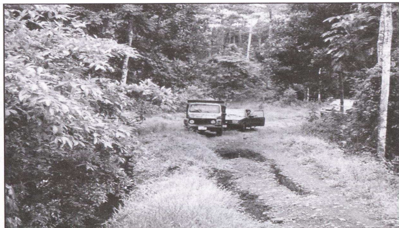
Figura 2 Camino destruido por erosión.
