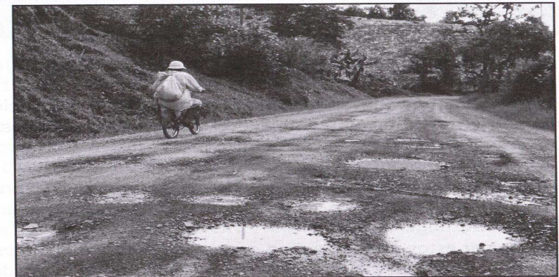
Figura 1 Camino debilitado por causa del agua.
