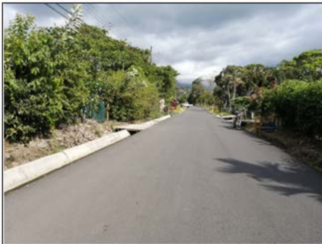
Imagen 13. Zona de estudio, ruta 1-19-0033 inexistencia de demarcación horizontal.
