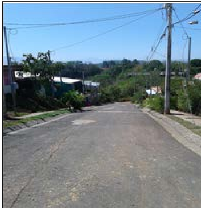
Figura N°4. Aceras, cunetas y pendiente superior al 5%
