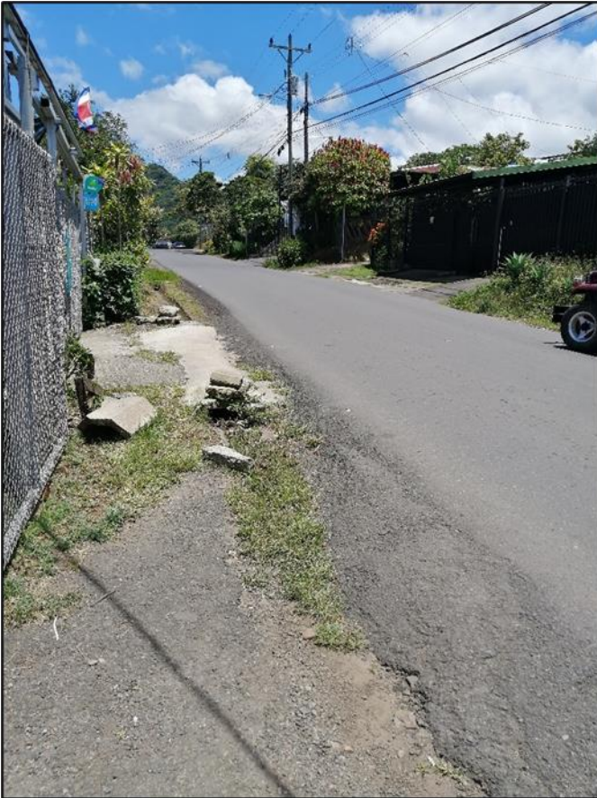
Figura 3. Secciones faltantes de acera y señalamiento horizontal desgastado, Corralillo, Cartago. Fuente: Propia.
