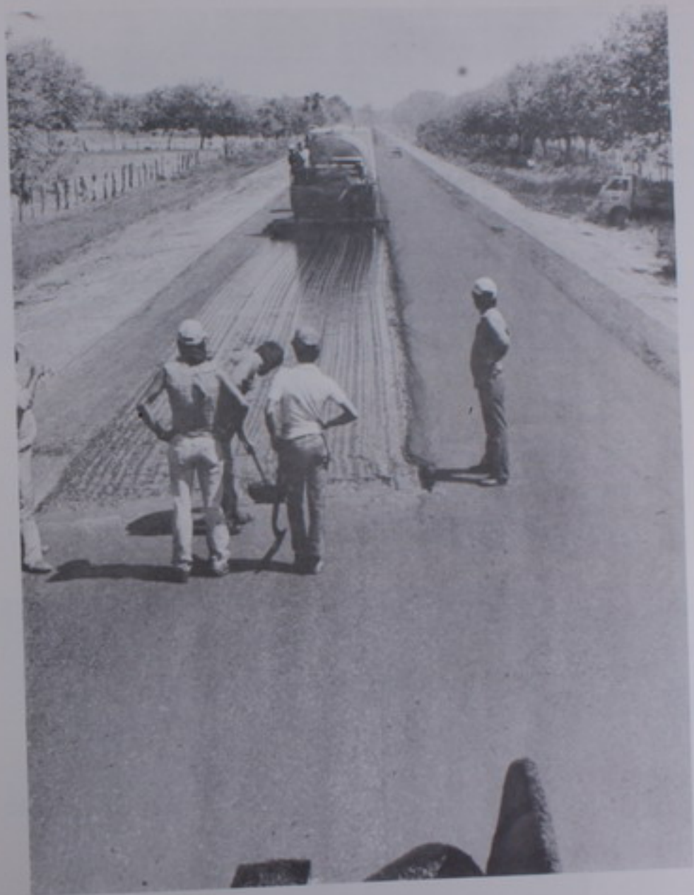
LIBERIA-SANTA CRUZ.- Otro de los trabajos que realiza el MOPT para el mejoramiento de las carreteras, es la colocación de una carpeta asfáltica en la vía que une a Liberia con Santa Cruz. Estas mejoras permitirán a los usuarios desplazarse más rápido y contar con mayor estabilidad.
