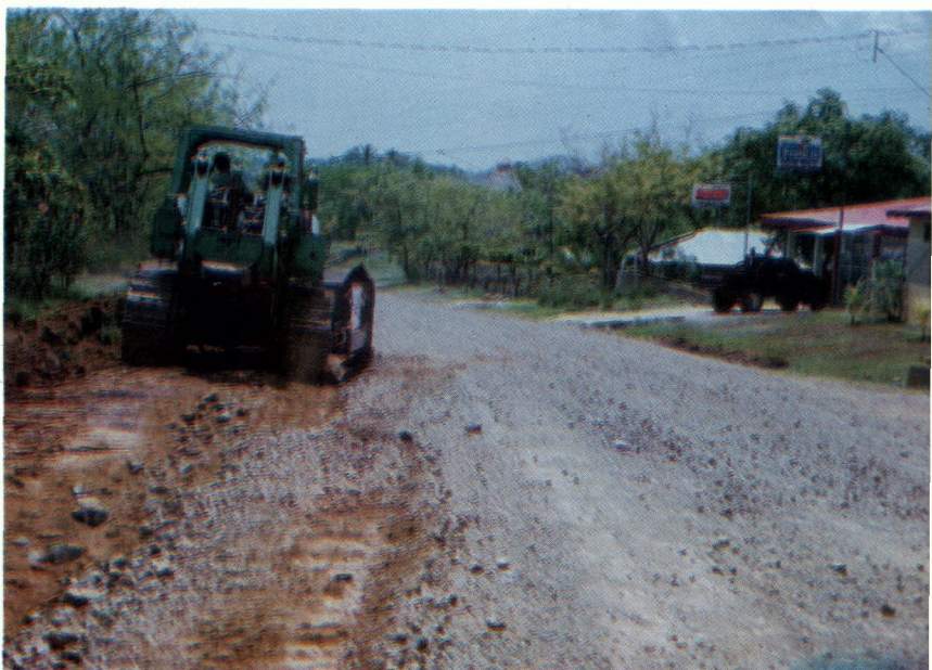
Calle Real, en Puntarenas. Una calle de Bagaces. En Flamingo, el balneario sobre el Pacífico. Un camino vecinal en Sixaola.
