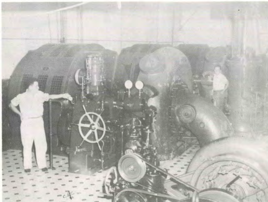
PLANTA ELECTRICA DE TACARES
