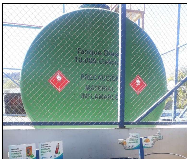
Figura 8: Tanque de almacenamiento de diésel ubicado en plantel de Grupo ATD
