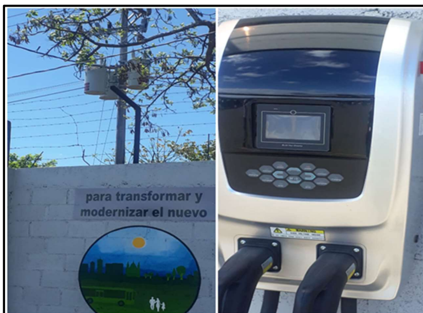
Figura 10: Cargador doble instalado en plantel de Grupo ATD
