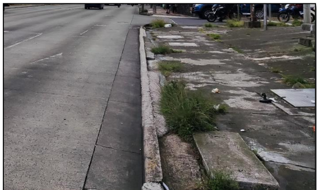
Figura. 10 Situación de la condición de las aceras, en la intersección de Ruta Nacional N218 y Calle73D, con el afloramiento de vegetación, por grietas en la superficie.
