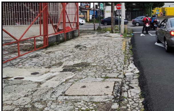
Figura. 9 Situación de la condición de las aceras, en la intersección de Ruta Nacional N218 y Calle73D, con el afloramiento de vegetación, por grietas en la superficie.
