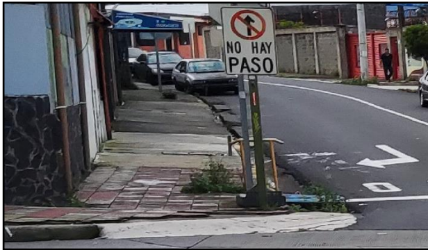
Figura. 7 Situación de la condición de las aceras, en la intersección de Ruta Nacional N218 y Calle73D, con el afloramiento de vegetación, por grietas en la superficie.
