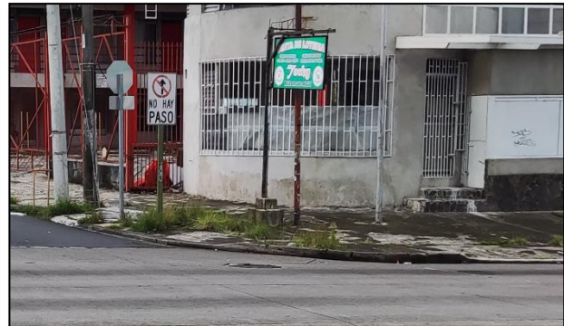
Figura. 8 Situación de la condición de las aceras, en la intersección de Ruta Nacional N218 y Calle73D, con el afloramiento de vegetación, por grietas en la superficie.
