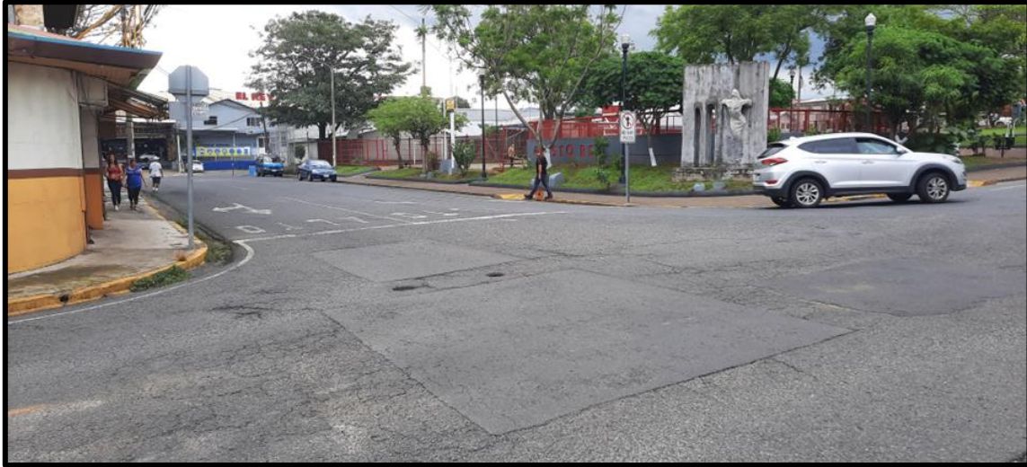
Figura 4 Piel de cocodrilo en carpeta de rodamiento, intersección calle 18 – avenida 1, Alajuela, Alajuela. Fuente: Propia.
