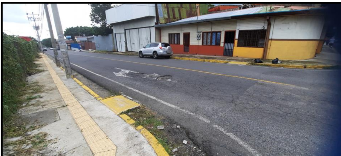
Figura 3 Baches y piel de cocodrilo en carpeta de rodamiento de acceso oeste, intersección calle 18 – avenida 1, Alajuela, Alajuela. Fuente: Propia.
