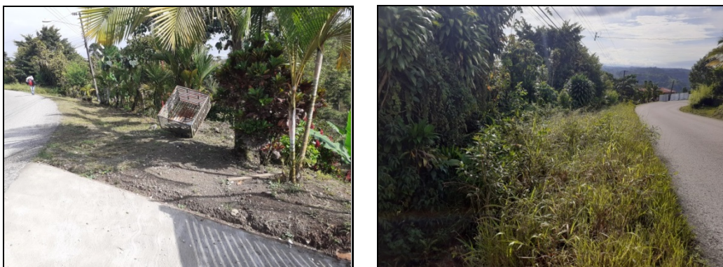
Figuras 64 y 65. Precipicio en Gutiérrez Braun - San Vito en la margen de la calzada del sitio 14.
