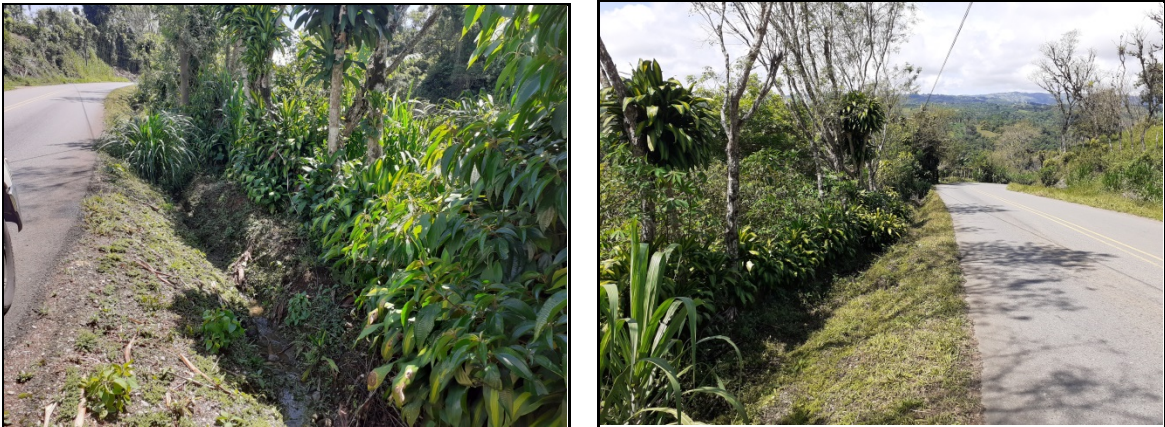
Figuras 108 y 109. Precipicio en San Vito - Gutiérrez Braun en la margen de la calzada del sitio 25.
