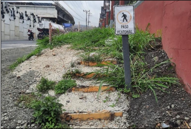
Ilustración 32 Estado de los pasos peatonales
