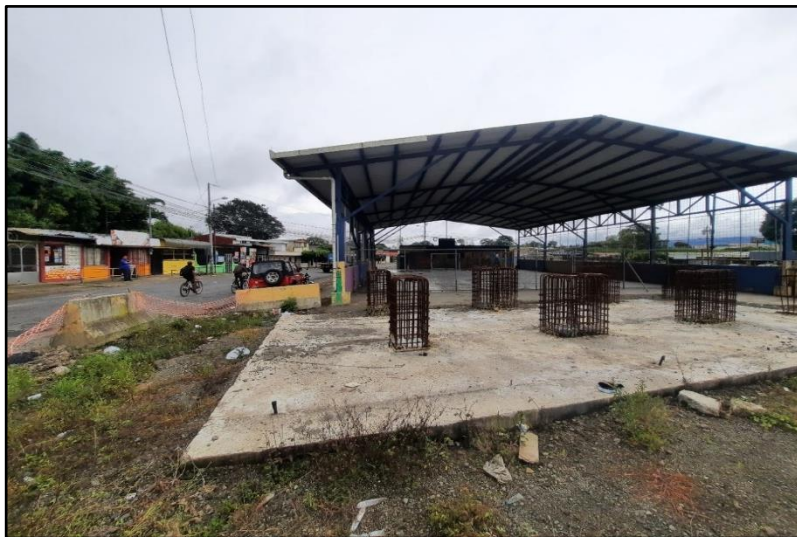
Ilustración 24 Afectaciones al espacio comunal de La Lima
