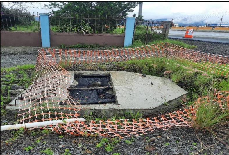
Ilustración 27 Afectaciones al espacio comunal de La Lima
