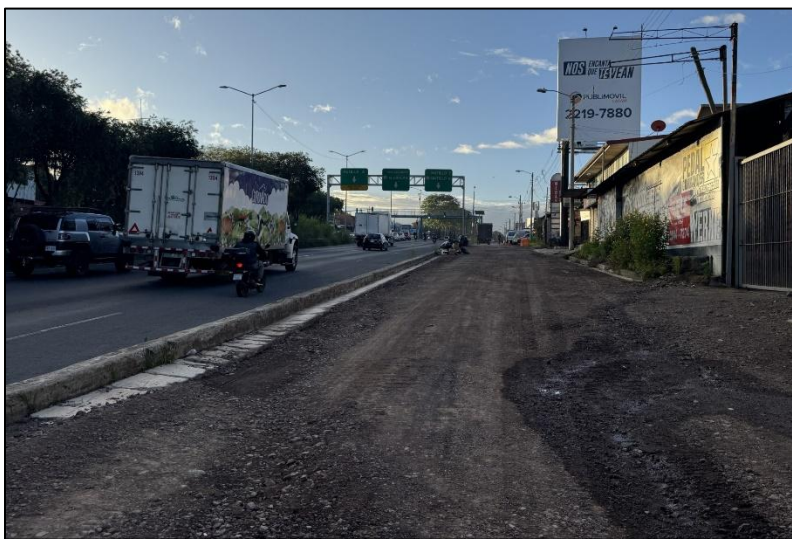
Fotografía 8 Vía marginal que viene del paso a desnivel curvo, avance del mismo visto de oeste a este.
