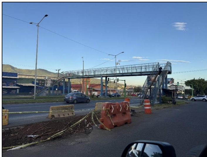
Fotografía 10 Vista de oeste a este. Puente peatonal a demoler y avance en ruta marginal.
