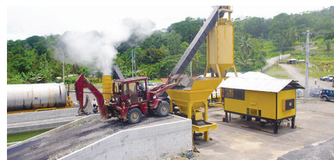
Planta asfáltica ubicada en Siquirres
