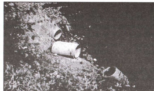
Foto 18: Colapso de alcantarilla sin cabezales
