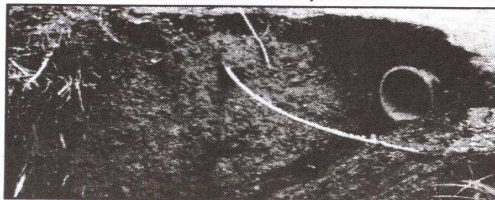
Foto 19: Alcantarilla y camino deteriorado por falta de cabezales y estructuras de protección.
