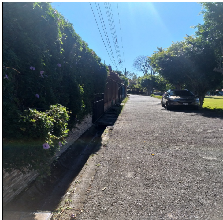
Figura N° 5 Caño y asfalto en buen estado, no hay acera.
