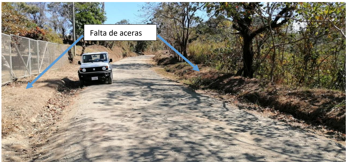
Imagen N° 4. Falta de acera.
