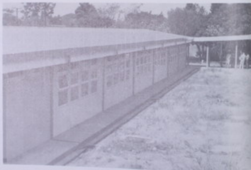
Pabellón de aulas del Liceo Nuevo de Pavas que construyó el MOPT por medio de la Dirección General de Edificaciones Nacionales. Esta obra forma parte de los trabajos de ampliación que se efectuaron en el Liceo, que consistieron en la construcción de seis aulas, una batería de servicios sanitarios, un paso a cubierto y obras exteriores.
