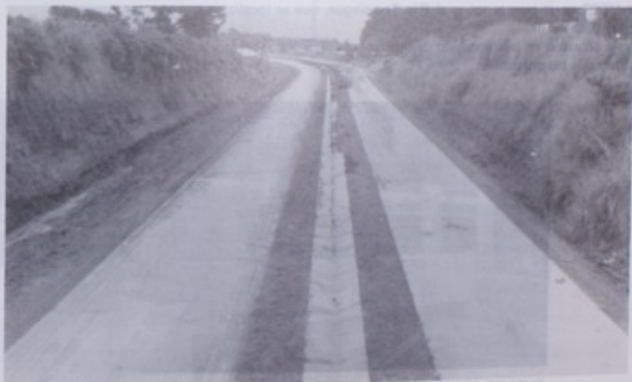
SAN JOSE – SIQUIRRES. – Próxima a terminarse se encuentra la construcción de la carretera San José - Siquirres, que facilitará el acceso a una importante zona agrícola localizada al noroeste del país y a los dos principales puertos de la Vertiente Atlántica: Moín y Puerto Limón.
