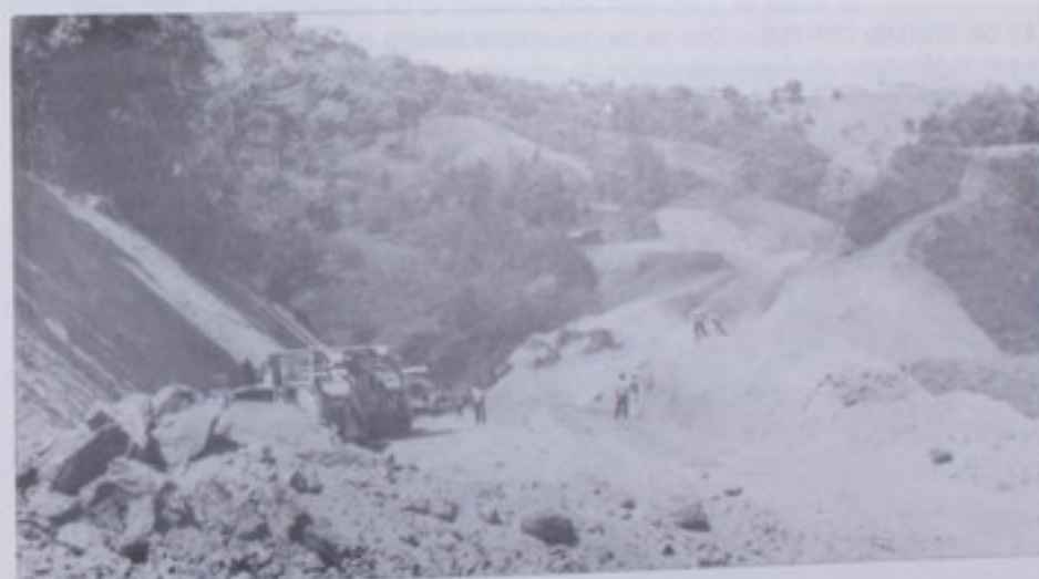
SAN ISIDRO DE EL GENERAL – DOMINICAL. – En la Zona Sur del país construye el Ministerio la importante carretera denominada San Isidro-Dominical. La construcción de esta vía que cuenta con una longitud de 324 kilómetros y su costo se estima en 184 millones de colones, dará inicio en el cantón XIX de Pérez Zeledón y finaliza en Cantón V de Osa.
