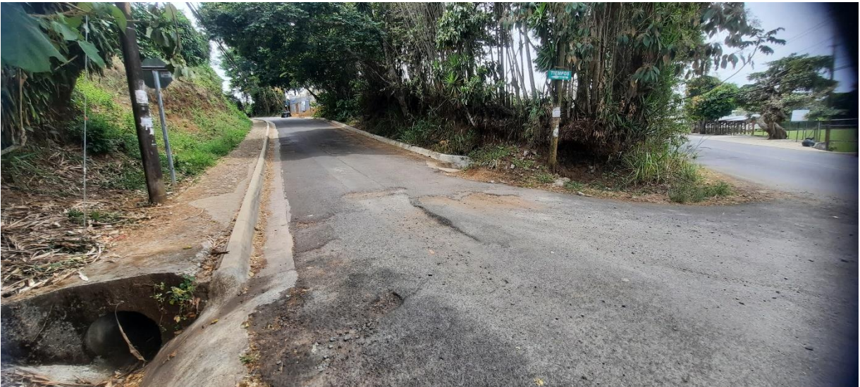
Figura 8 Daños en la estructura del pavimento de calle Quebradas con ruta nacional N.º 107, Tambor de Alajuela. Fuente propia.
