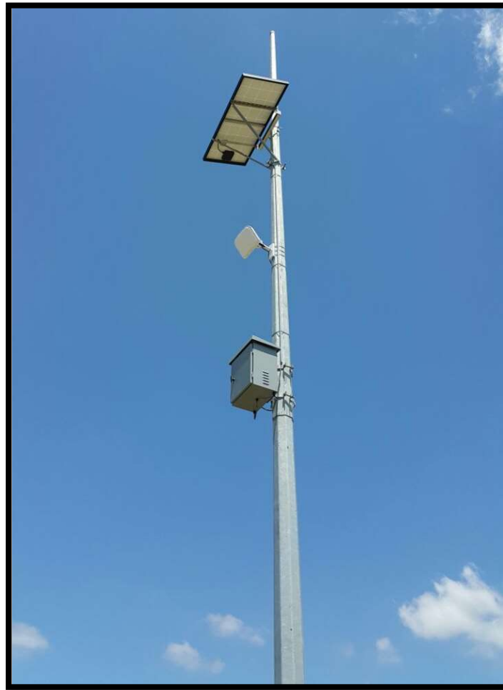
Figura 1: Imagen que muestra la apariencia de una estación de radar del MOPT: con su un panel solar, el dispositivo detector de radar (color blanco) y el gabinete de control
