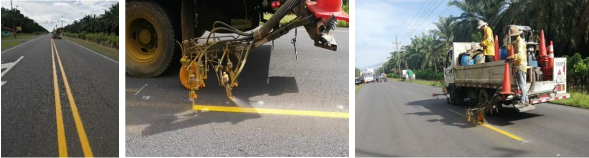
Figura 3. Demarcación línea centro amarilla
